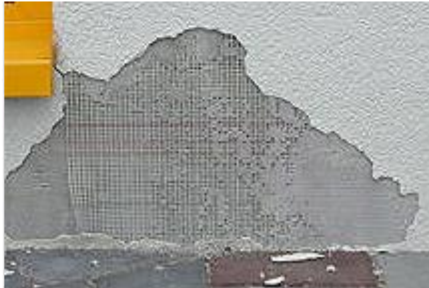
STRATO INSUFFICIENTE DI RASANTE A COPERTURA DELLA RETE
